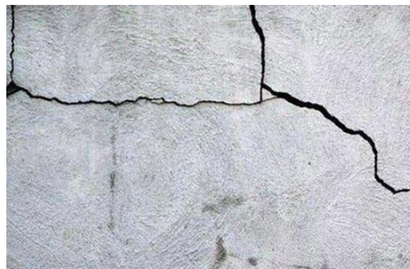
图 1 收缩裂缝示例图
