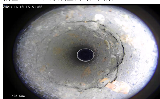
图 3.5 2 孔孔内摄像图片(缺陷位置)
