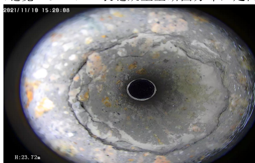
图 3.5 1 孔孔内摄像图片(缺陷位置)
