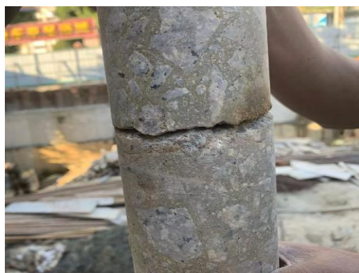
图 3.3.1 孔芯样（缺陷位置）
